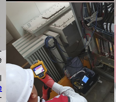
Estudio de termografía en transformador y tableros
